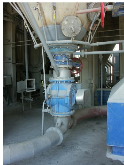
Sas alvéolaire d'expédition et fluidisation du fond de silo
