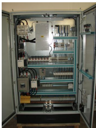
Armoire de commande avec automate programmable
