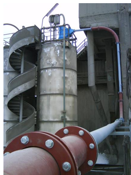
Circuit de transport pneumatique avec coudes anti-abrasion et pot de détente à l'arrivée sur le silo
