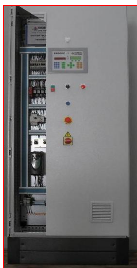
Armoire de commande
